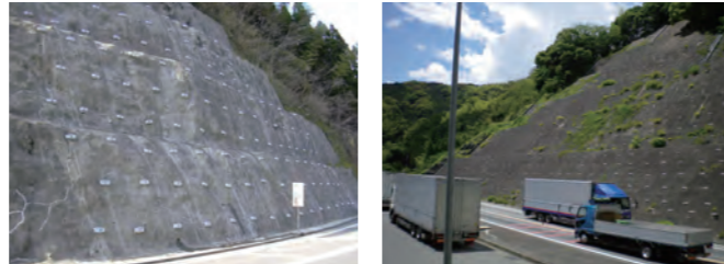
■老朽化が著しい既設モルタル吹付面に
